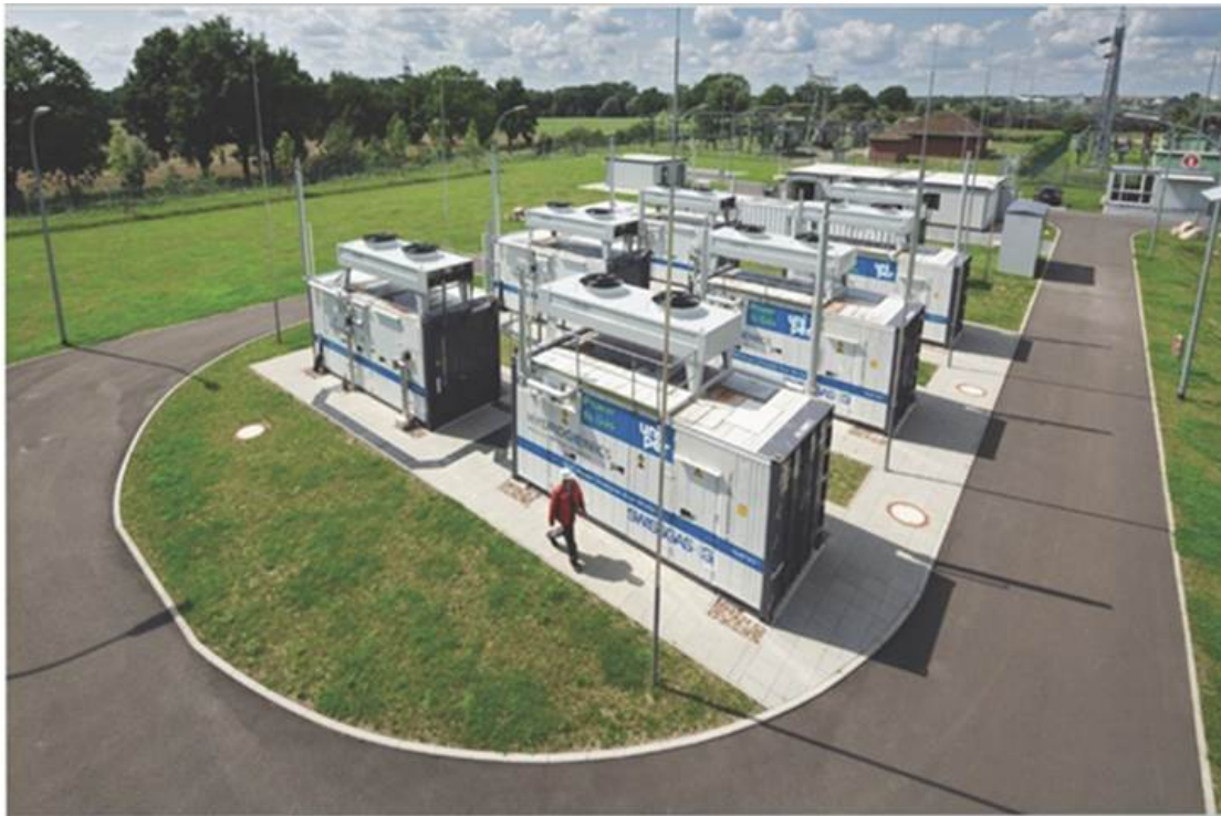
Pilotprojktanlage Power to Gas in Falkenhagen (Prignitz) im Land Brandenburg
